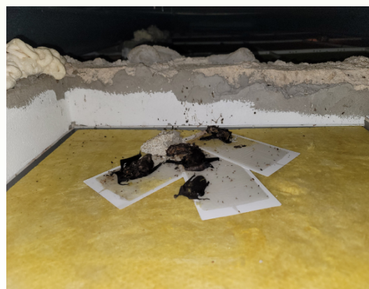
Evidencia de técnicas ilegales e inefectivas descubiertas por Bat Exclusion al inspeccionar una propiedad. Fotografía: Archivo BE
